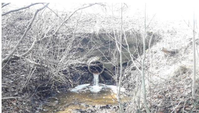
Pilt 3 – 20240327 Väike-Koru eesvoolu kraavi betoonruubi väljavool 11184 Alliku-Laagri-Hüüru teel. Truubi betoonist portaal on vajunud kaldu ja alumine osa on murenenud.
