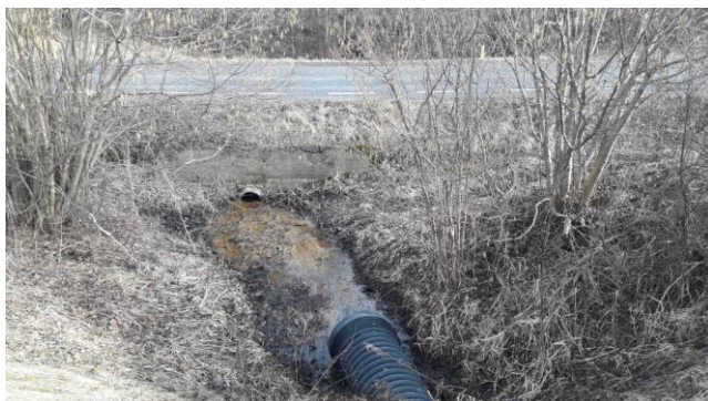
Pilt 2 – 20240327 Väike-Koru eesvoolu kraavi settinud betoontruup 11184 Alliku-Laagri-Hüüru teel.
